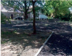
Widok na nowy ciąg komunikacyjny i kwatery sadzenia roślin (fot. N. Jandy)
